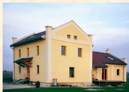
Mlyn v Hrubom Šúri prerobený na rodinný dom. Z tehlového muriva sa dala doslova „žmýkať“ voda“. Po podrezaní muriva bola stavba zateplená systémom STYREXON® k plnej spokojnosti investora.
