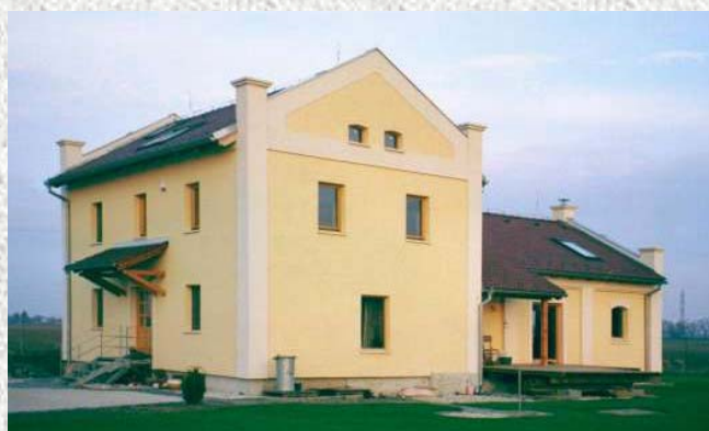
Zateplenie systémom STYREXON na fasáde mlynu v Hrubom Šuri zároveň vyriešilo aj odvlhčenie muriva
